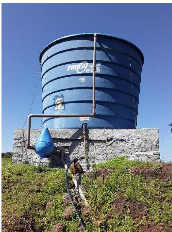
Figura 58 – Reservatório do SAA Segredinho II.
