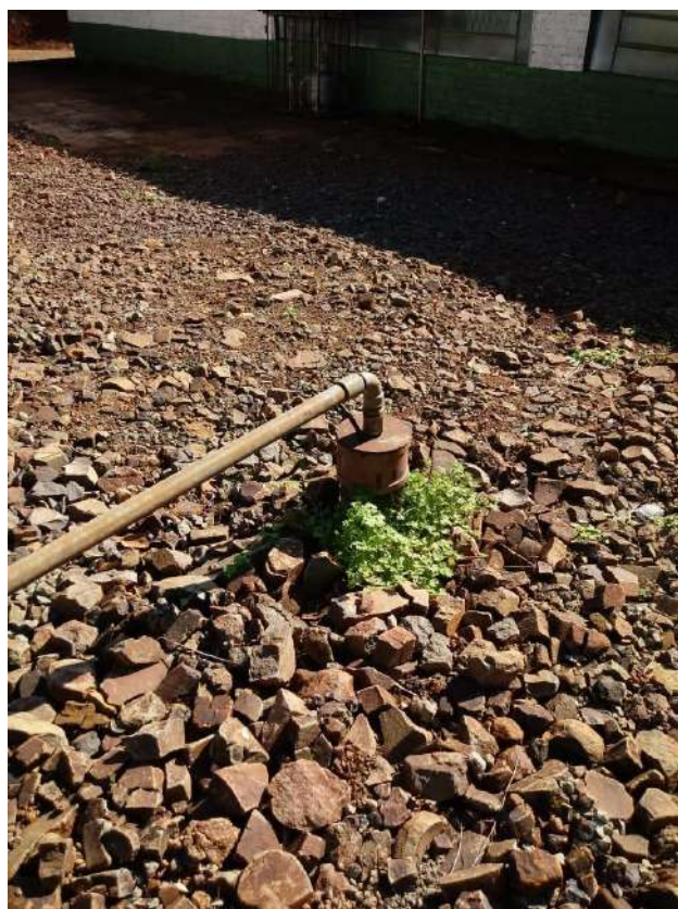
Figura 37 – Vista do poço do SAA Linha Vitória.
