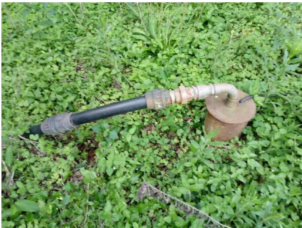
Figura 39 – Vista do poço do SAA Linha Guamirim I.
