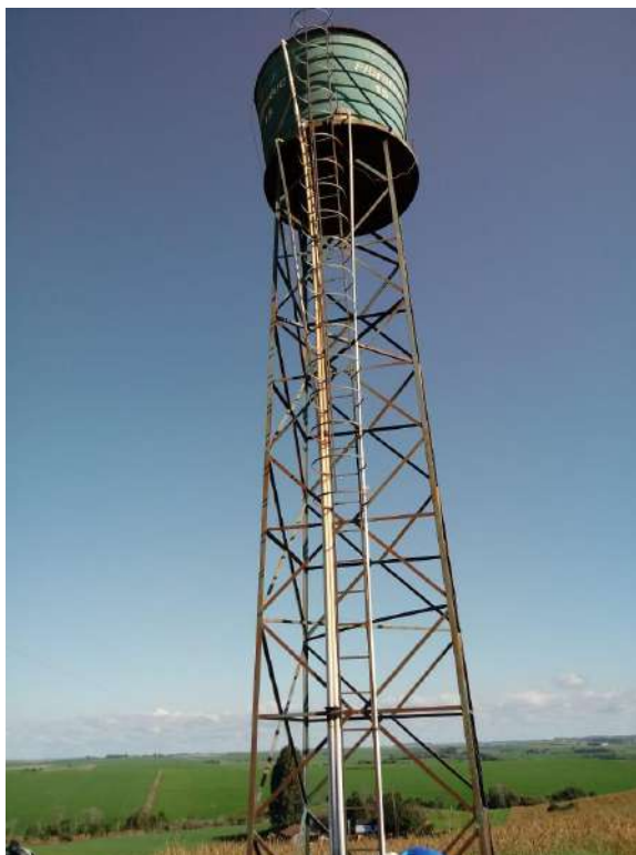
Figura 60 – Reservatório do SAA Linha Barichello.
