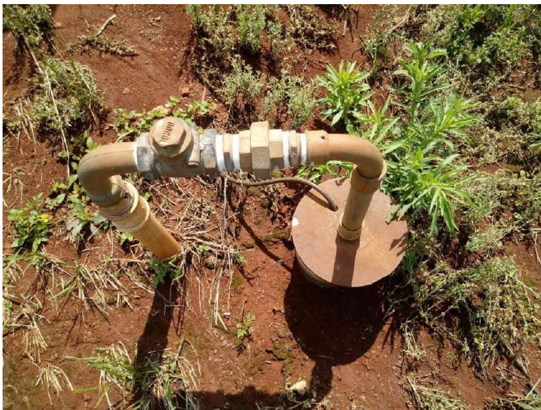
Figura 38 – Vista do poço do SAA Linha Barichello.
