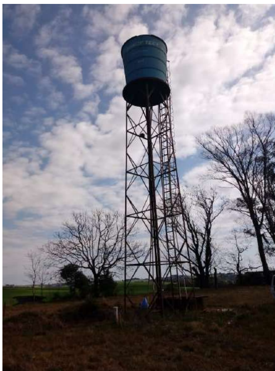
Figura 67 – Reservatório do SAA Mata Cobra.
