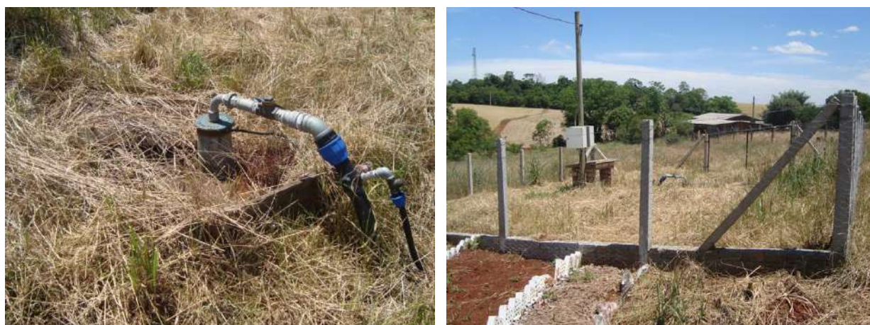
Figura 33 – Vista do poço da Associação de Rincão do Segredo – SAA Segredo Canhada Funda.
