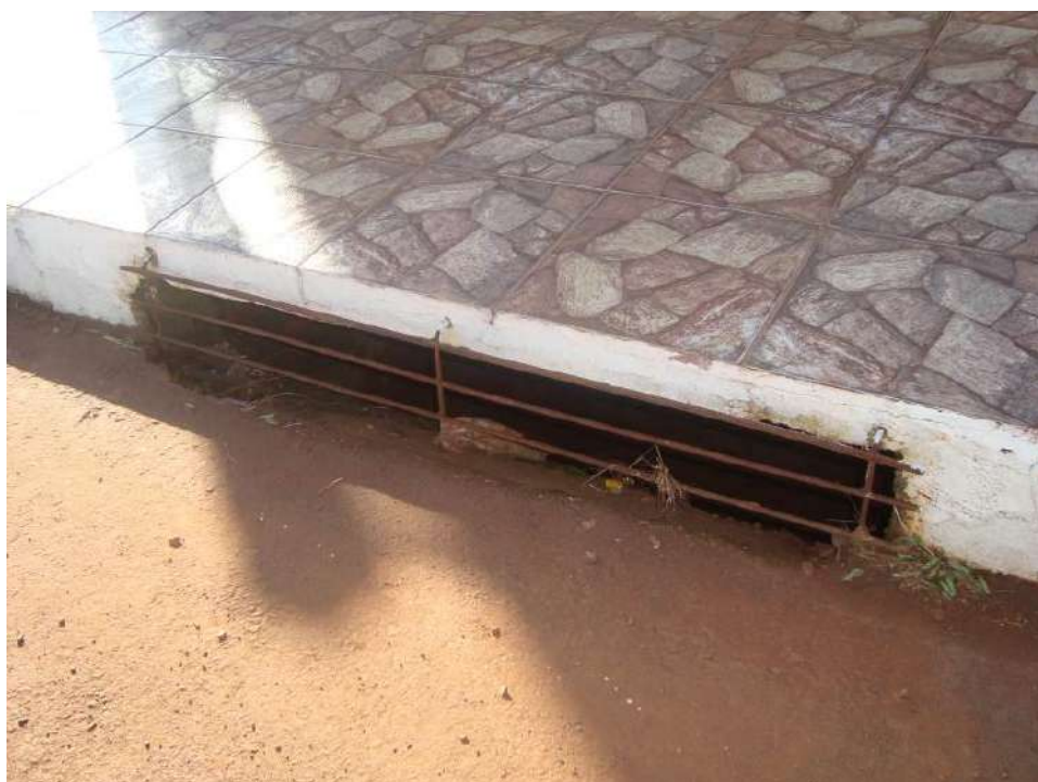
Figura 90 – Bueiro instalado corretamente na sarjeta, contendo grade de contenção.
