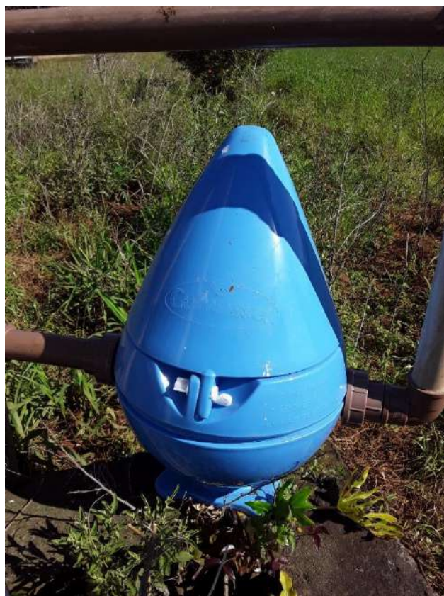
Figura 48 – Equipamento de tratamento SAA Linha Barcarollo.
