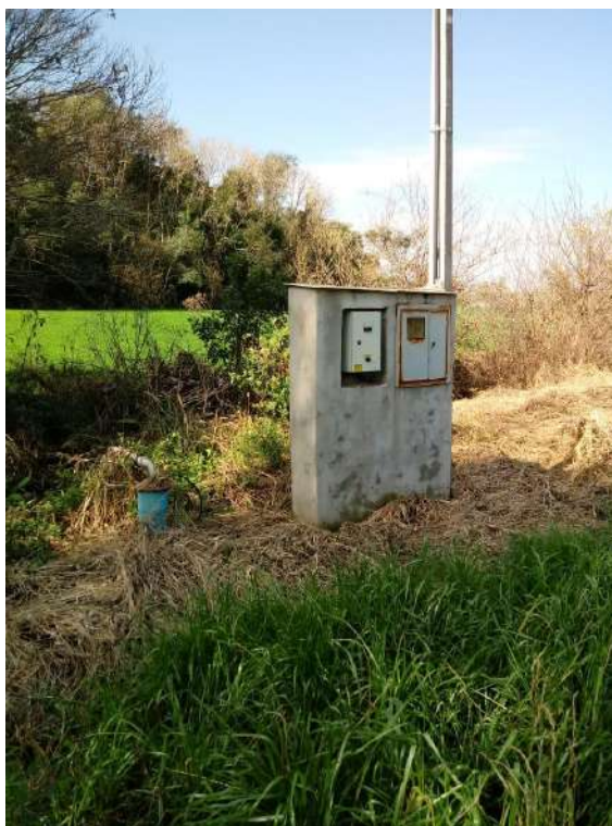
Figura 30 – Vista do poço e quadro de comando do SAA Linha Dupla.
