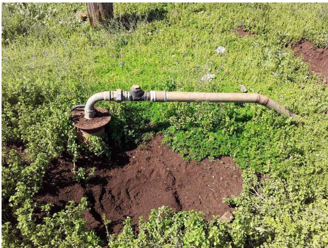
Figura 45 – Vista do poço do SAA Segredo Poço Grande.
