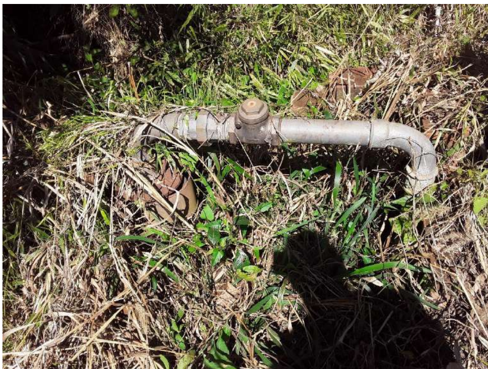
Figura 34 – Vista do poço da Associação de Rincão do Segredo – SAA Segredo Vila.
