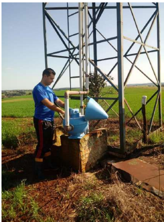
Figura 51 – Equipamento de tratamento poço da Linha Quadros I.
