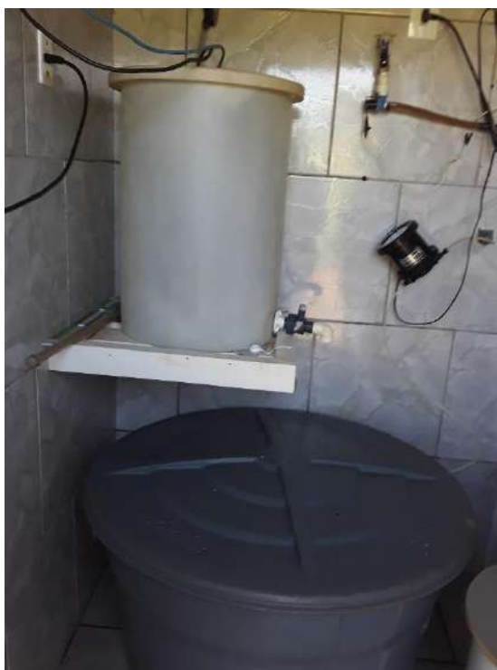
Figura 47 – Equipamento de tratamento poço Tamandaré, localizado na zona urbana.
