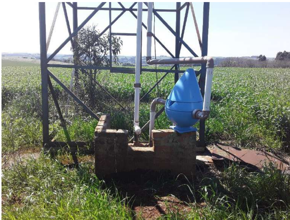
Figura 50 – Equipamento de tratamento SAA Segredinho II.
