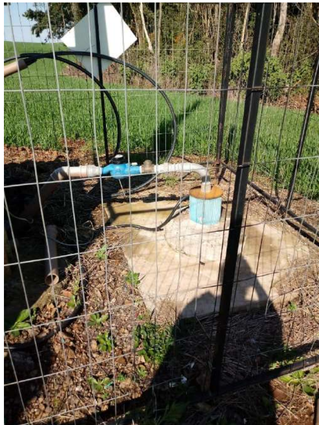
Figura 41 – Vista do poço do SAA Linha Barra.
