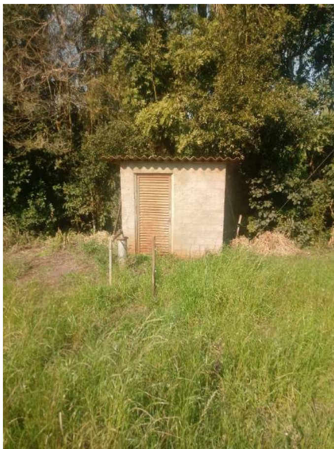
Figura 46 – Vista do poço do SAA Mata Cobra.
