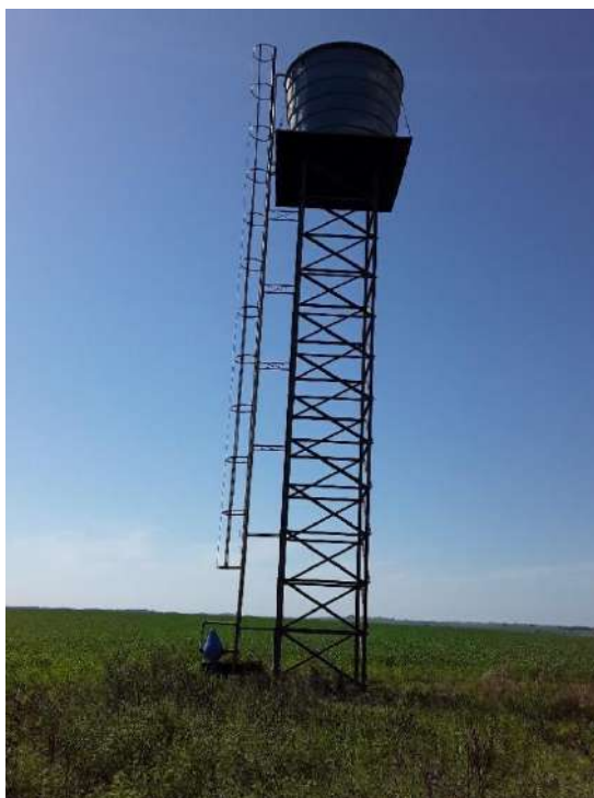
Figura 54 – Reservatório do SAA Linha Barcarollo.
