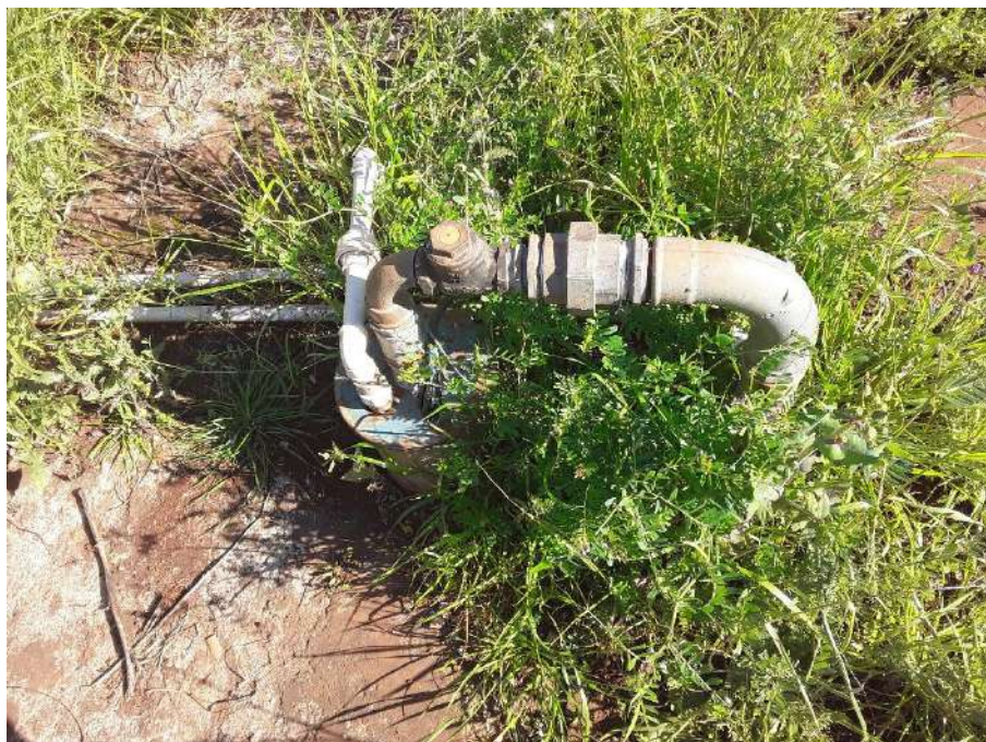
Figura 31 – Vista do poço do SAA Linha Barcarollo.
