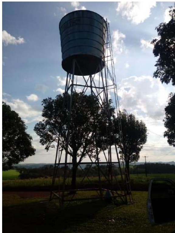
Figura 56 – Reservatório do SAA Segredo-Vila.
