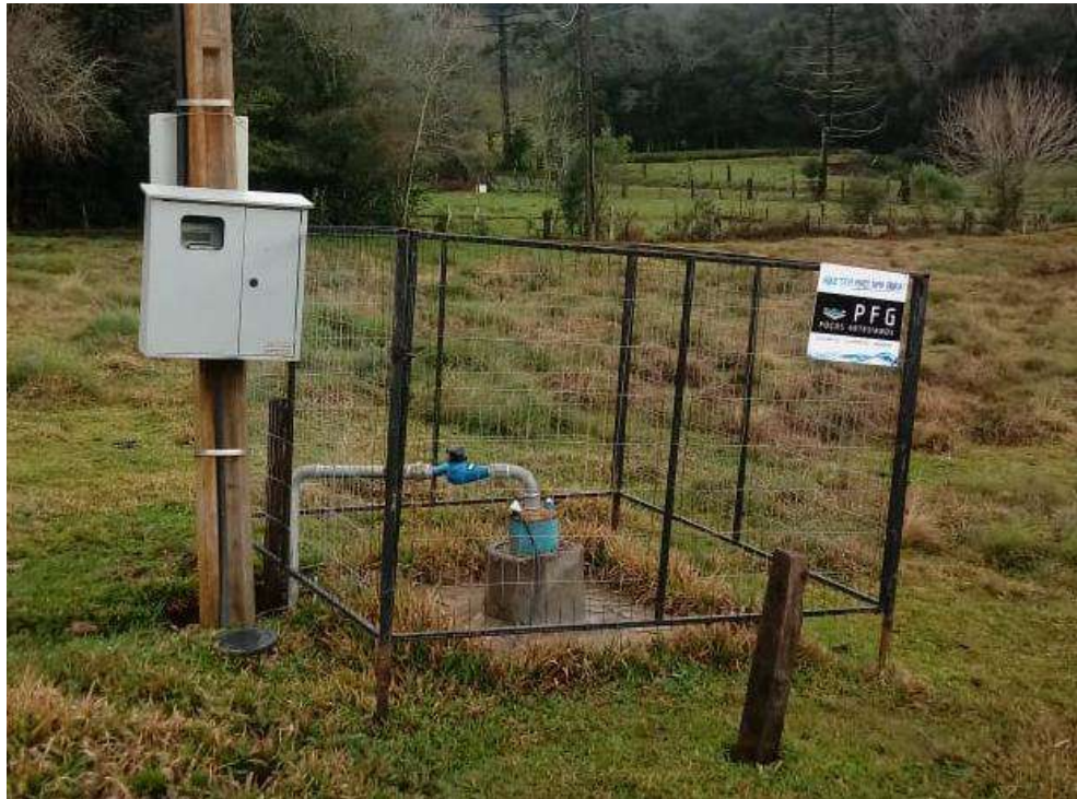
Figura 40 – Vista do poço do SAA Linha Guamirim II.
