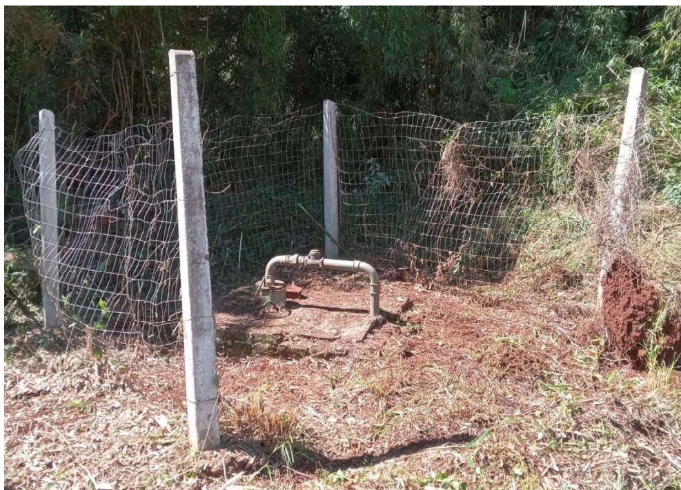
Figura 34 – Vista do poço da Associação de Rincão do Segredo – SAA Segredo Vila.
