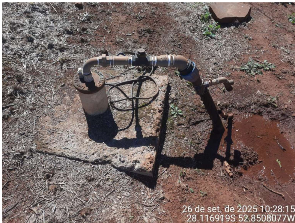
Figura 33 – Vista do poço da Associação de Rincão do Segredo – SAA Segredo Canhada Funda.
