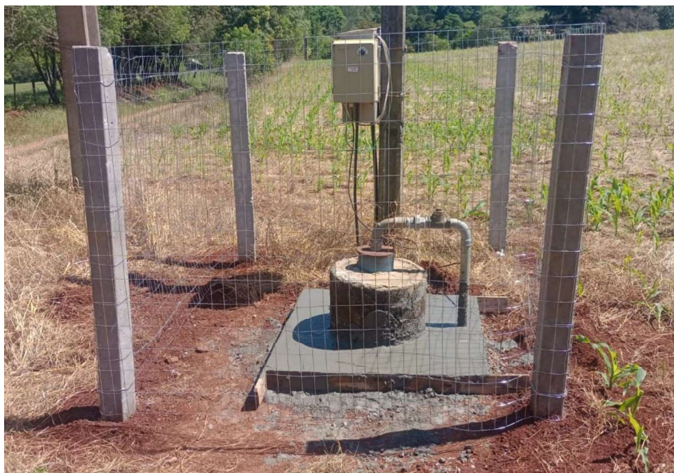
Figura 49 – Vista do poço do SAA Linha Barichello – Propr. de Gervasio Barichello.
