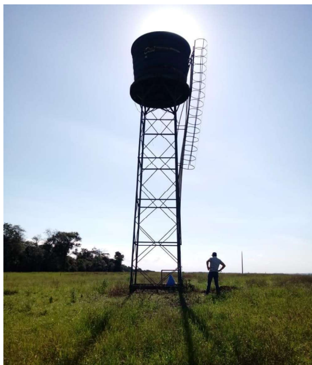
Figura 70 – Reservatório do SAA Linha Barra.
