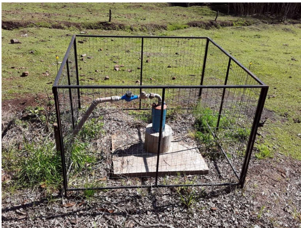
Figura 36 – Vista do poço da Associação de Segredinho – SAA Segredinho II.
