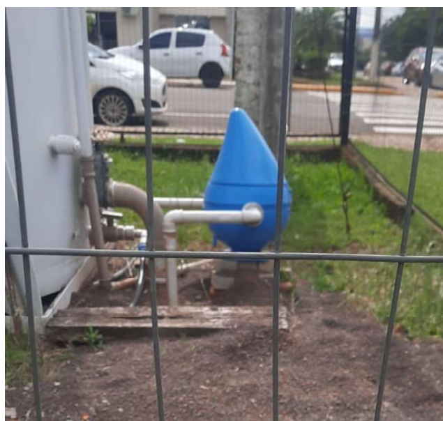
Figura 54 – Equipamento de tratamento poço 2, localizado na zona urbana.
