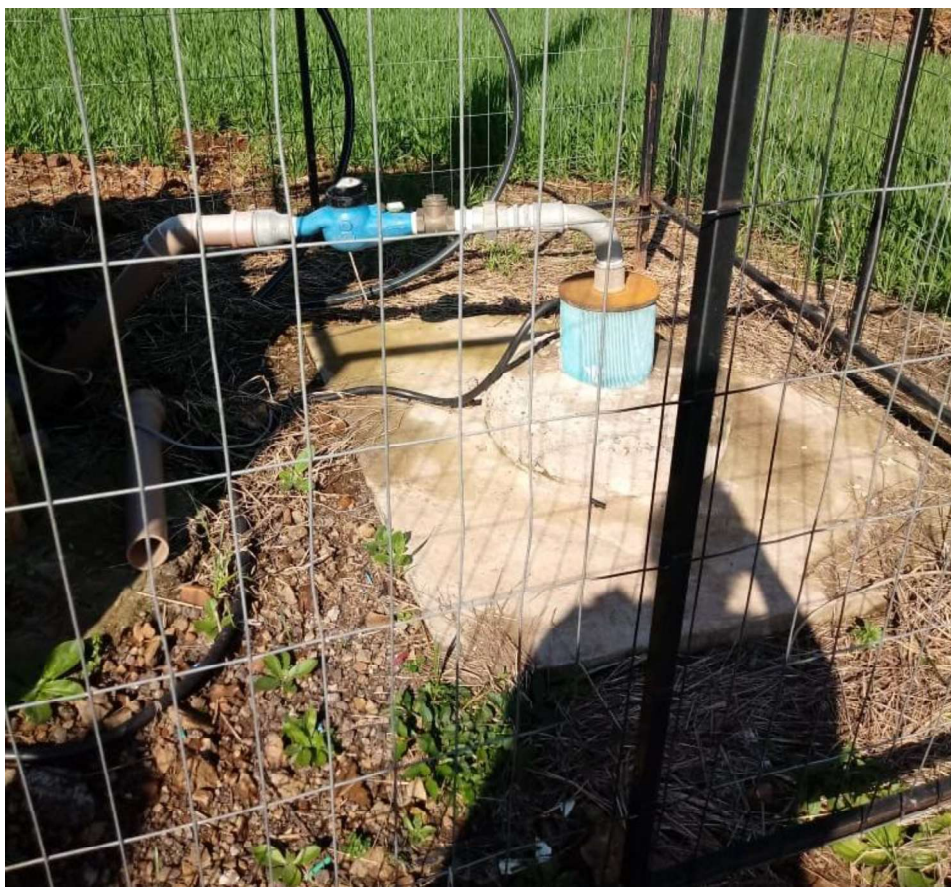
Figura 41 – Vista do poço do SAA Linha Barra.
