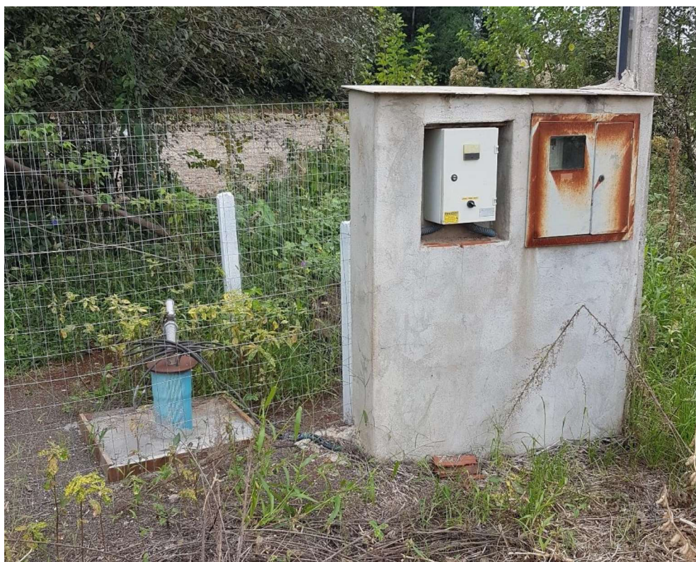
Figura 30 – Vista do poço e quadro de comando do SAA Linha Dupla.
