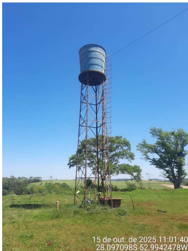
Figura 74 – Reservatório do SAA Mata Cobra – Pavilhão.
