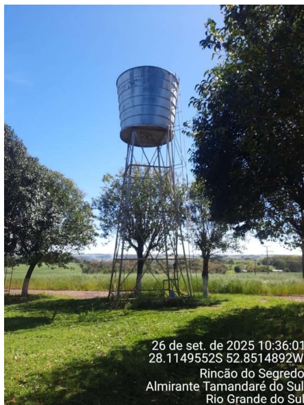
Figura 62 – Reservatório do SAA Segredo-Vila.
