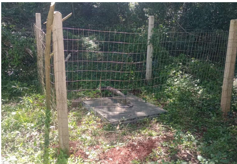
Figura 39 – Vista do poço do SAA Linha Guamirim I.
