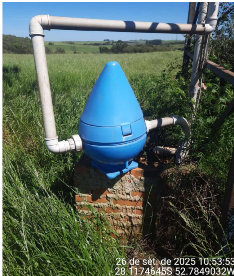
Figura 58 – Equipamento de tratamento poço da Linha Segredinho I.
