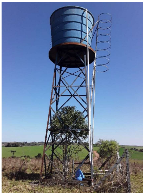
Figura 76 – Reservatório do SAA Segredo-Poço Grande.
