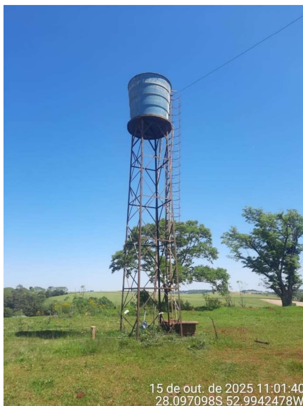
Figura 75 – Reservatório do SAA Mata Cobra – Francisco Maggioni.
