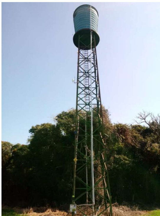
Figura 60 – Reservatório do SAA Linha Dupla.
