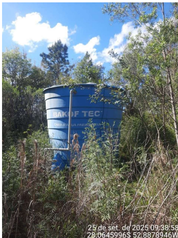
Figura 77 – Reservatório do SAA Linha Turvo
