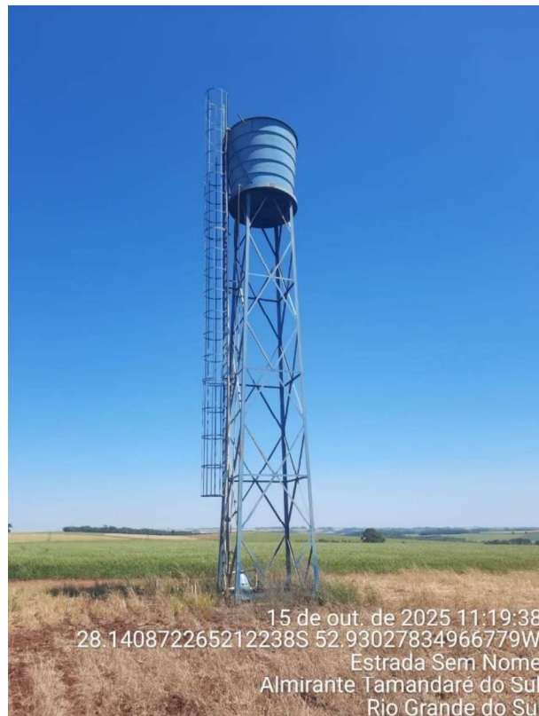
Figura 72 – Reservatório do SAA Linha Quadros II.
