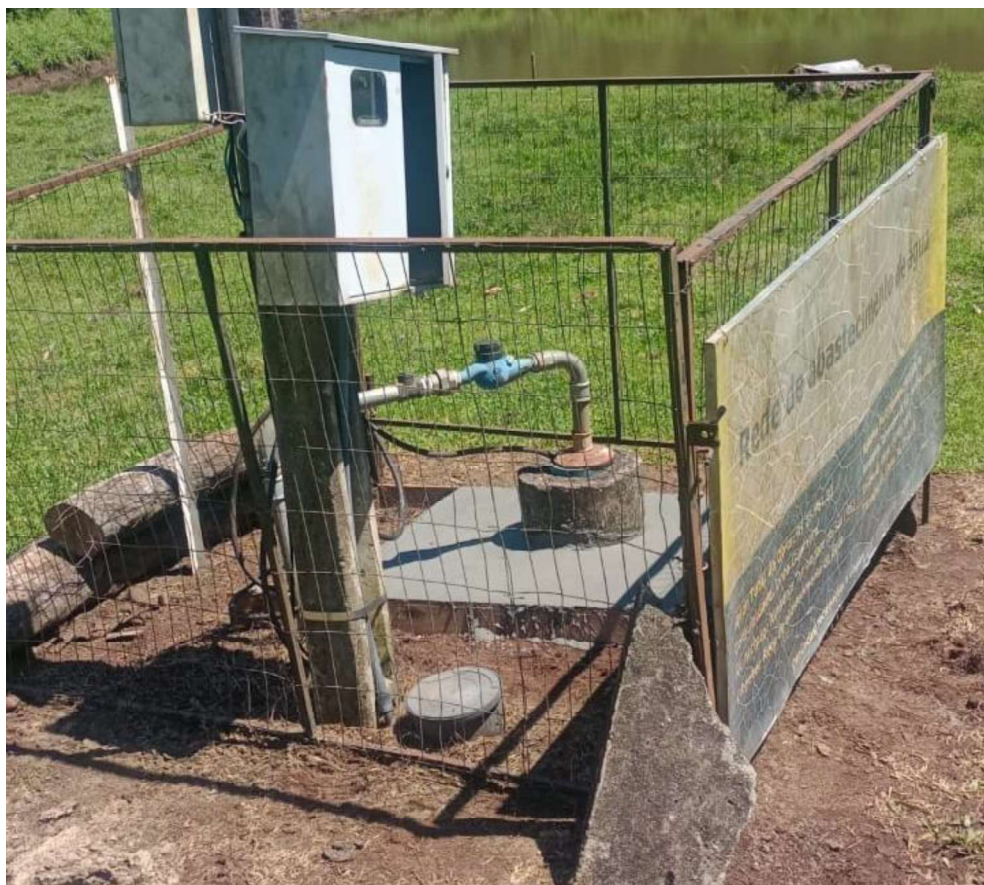
Figura 40 – Vista do poço do SAA Linha Guamirim II.
