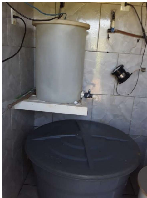
Figura 53 – Equipamento de tratamento poço 1, localizado na zona urbana.
