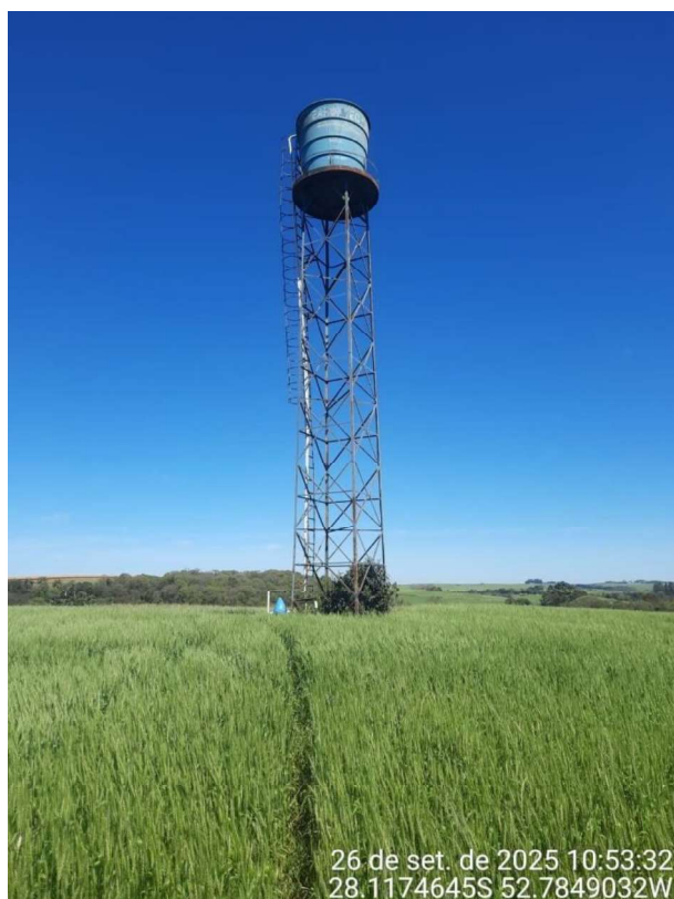
Figura 63 – Reservatório do SAA Segredinho I.
